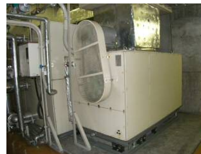
地下書庫系統 空調機
