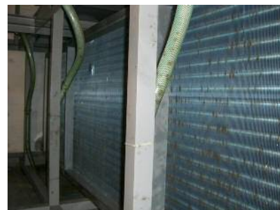
地下書庫 熱交換コイル 殺菌灯設置前
