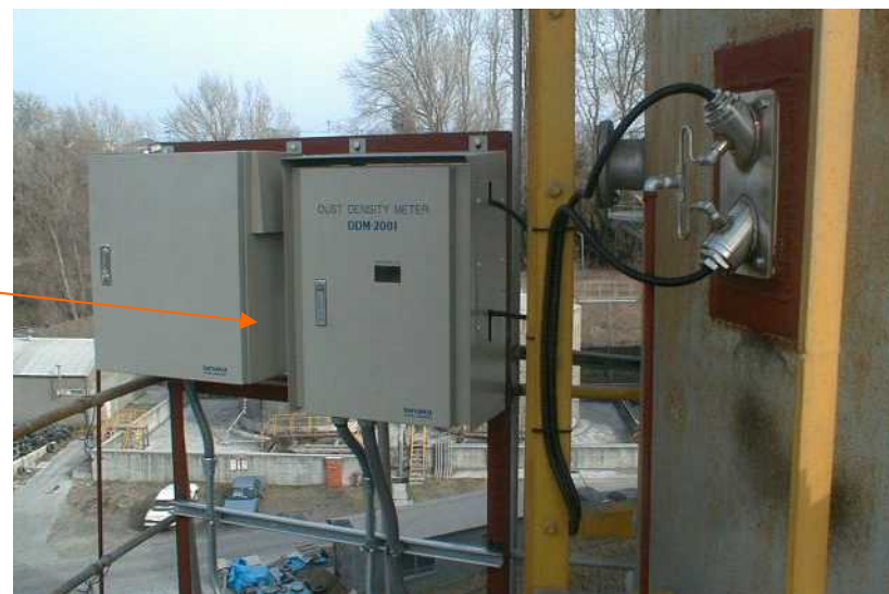
AQC(Air Quenching Cooler)電気集塵機出口煙突への設置
