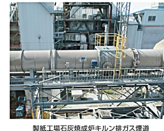
製紙工場石灰焼成炉キルン排ガス煙道
